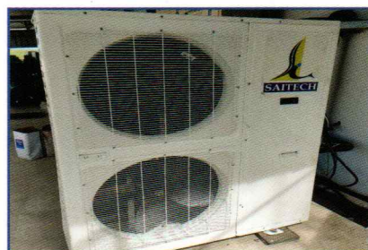
Out Door Condenser Unit
